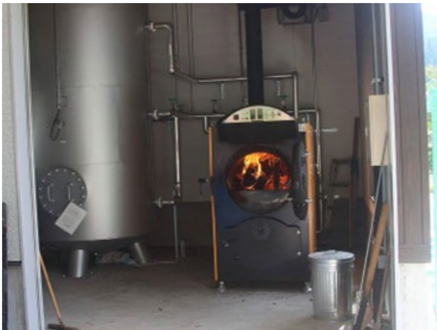
廃材等を活用した薪ボイラーによる加温
